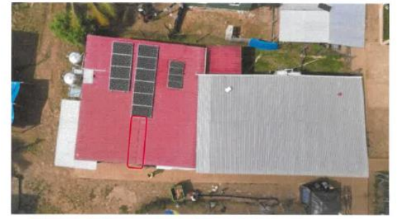
Figura 14. Vista aérea del techo del Puesto de Salud. Falta cielo raso donde debería haber un mueble fijo con lavamanos (Imagen del Ministerio de Salud)
