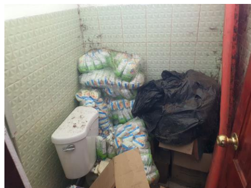
Figura 7: Servicios Sanitario utilizado como bodega.
